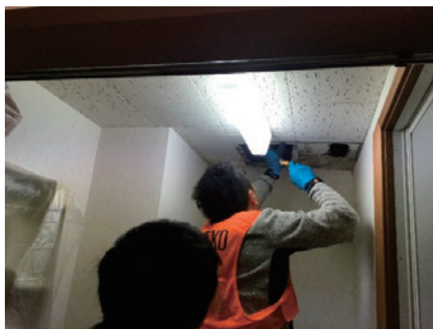
(写真1)2019年最上階洗面所漏水事故
